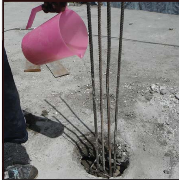
20. Apre nou fin koule beton an kanpe sou dal la pou wouze beton an twa (3) fwa nan yon jounen
