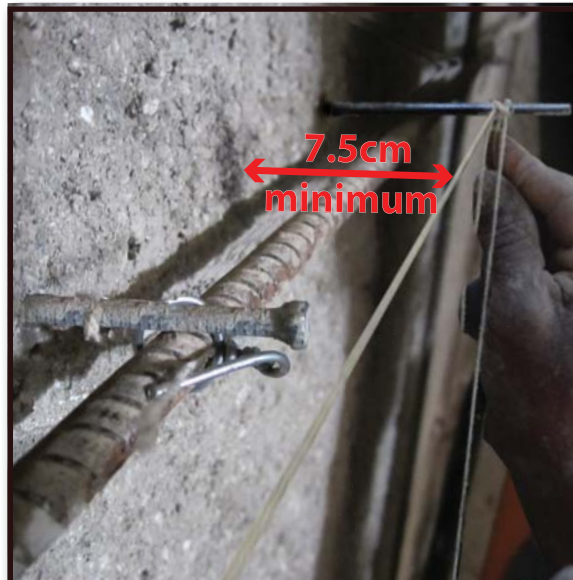
12. Itilize yon fisèl pou ede w respekte epesè kouch beton an. Fè yon jan pou epesè a ka fè 7.5 cm epi anwobaj la dwe 2.5 cm pou piti.
