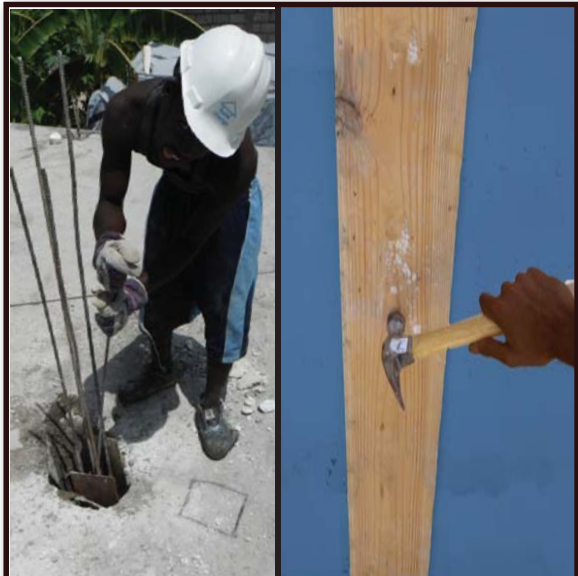
19. Apre chak bokit beton, sevi ak yon tij fè ki long pou ka konpakte beton an. Kanpe sou dal la pou fè sa. Pandan w ap vide beton an frape kofraj la ak yon mato . Metod sa ap ede beton an byen konpakte
