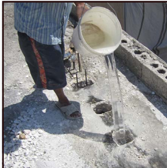
11. Mouye tout kote ki pral pran nouvo beton, ansanm ak tèt mi an blok la.
