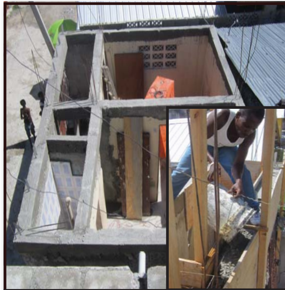
11. Plen chenay siperye a nan wòte fisèl la, e asire nou beton an byen vibre pou nou pa gen fè ki parèt, espas vid oubyen lot defo.
