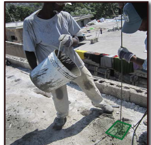
12. Kanpe sou dal la pou koule beton an. Frape kofraj la ak yon mato pou vibre beton epi ak yon bout fè pou konsolide beton an .
